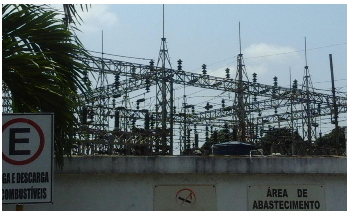
Figura 51 - Subestação de alta tensão no bairro Aleixo
